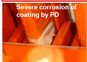
局放导致涂层严重腐蚀
